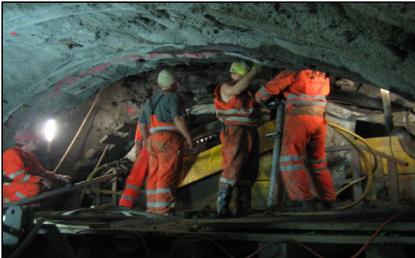
Abb. 11: Überfirstungsarbeiten zur Befreiung der TBM Gabi II im Gotthard-Basistunnel (Los Bodio) (vgl. [7])
