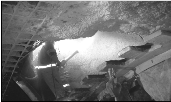
Abb. 2: Niederbrüche über der Ortsbrust beim Vortrieb Gotthard-Basistunnel (Los Faido) (vgl. [3])
