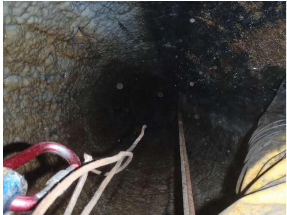
Betonausbau: starke Versinterung
