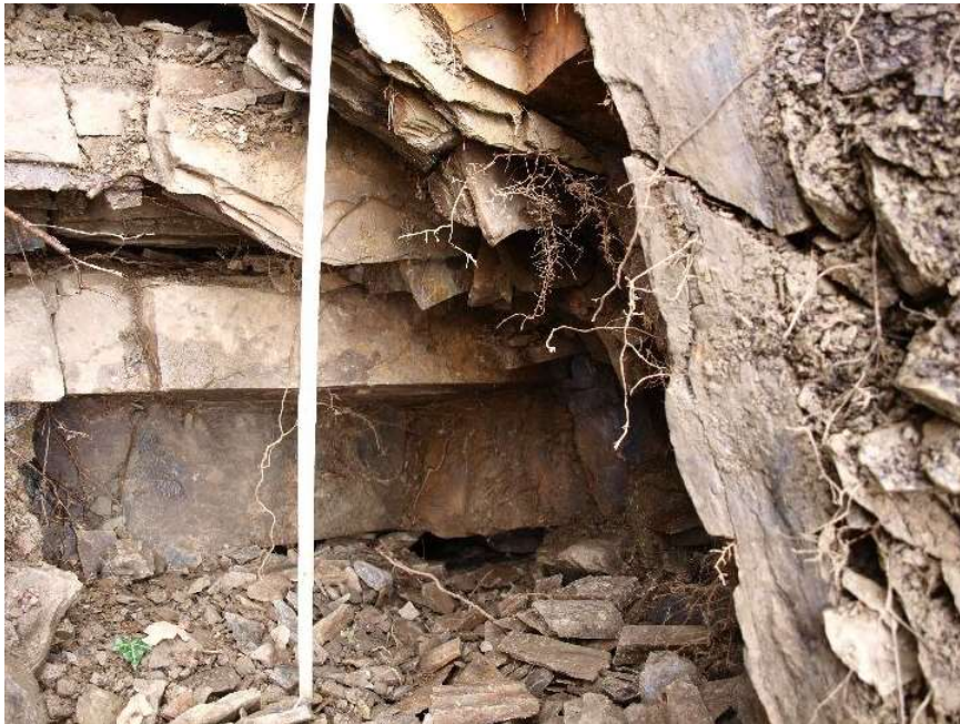
Firststollen Nordportal verstürzt
